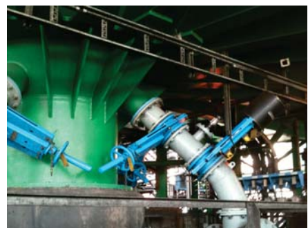
Planta de Lavado de Carbon
